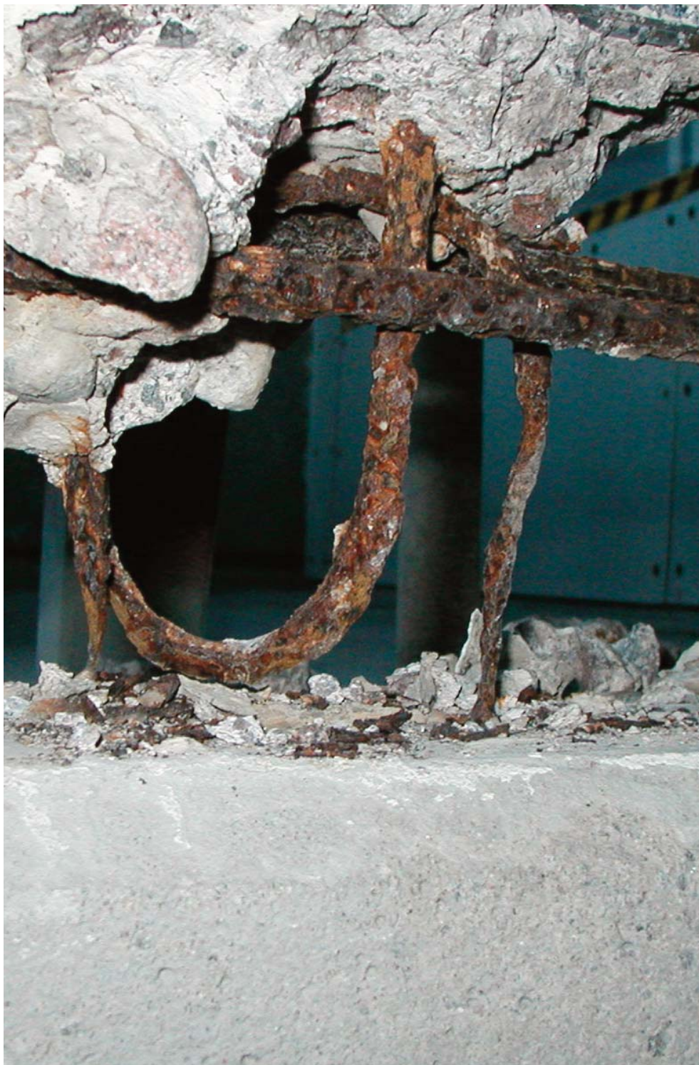
Rostiga armeringsjärn var det enda som höll många av föreningens balkonger uppe.
